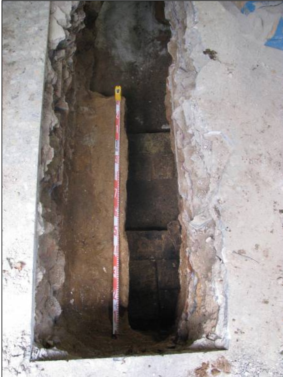
Foto 35. Afectació de la fossa sèptica UE 1044 per la rasa 1.
