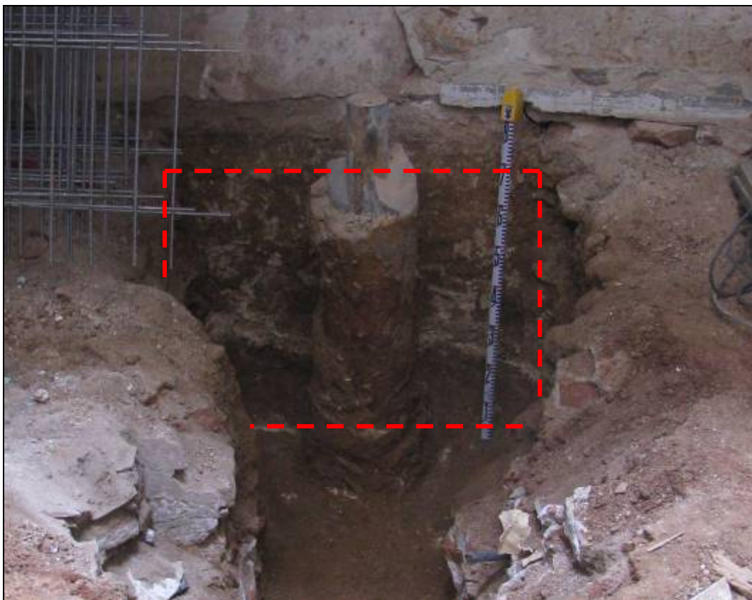
Foto 10. Mur UE 1023. Afectat per l'encepat 2.
