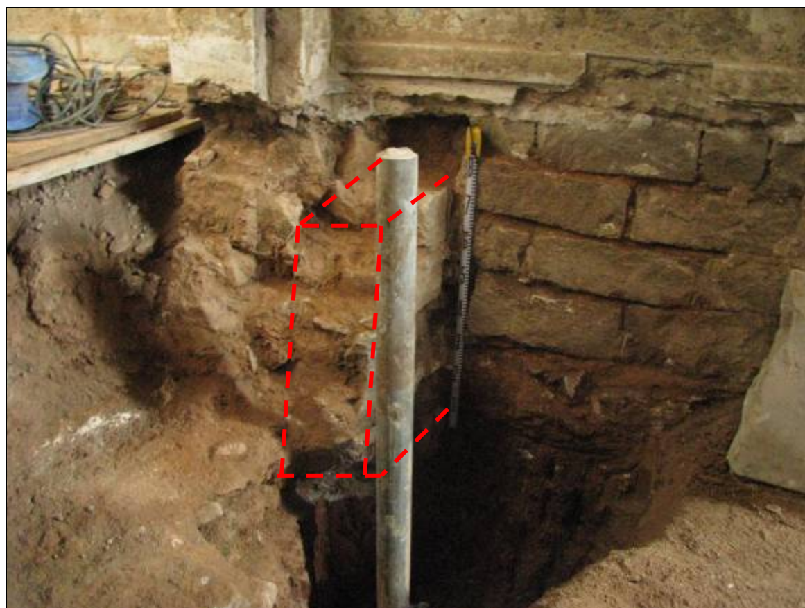
Foto 19. Mur UE 1021. afectació per l'encepat 4.
