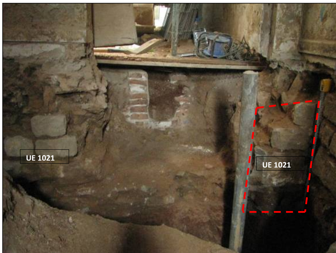
Foto 18. Mur UE 1021. afectació per l'encepat 4.
