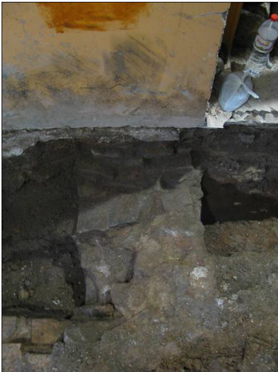
Foto 31. Afectació per la rasa 1 del mur UE 1036.
